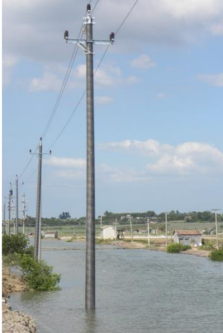
Abbildung 28: Stabile Strommasten aus Verbundstoffen von BASF
